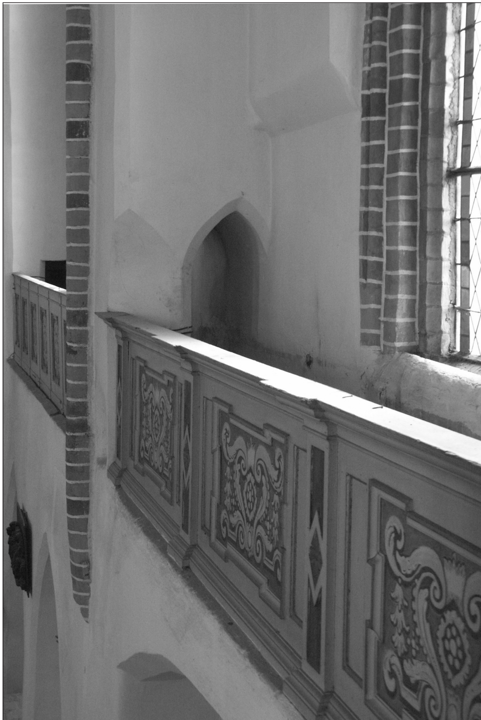
Ilustr. 16. Gryfice, kościół parafialny NMP, nawa południowa, struktura ściany z gankiem obiegającym, fot. Marek Fiedorowicz
